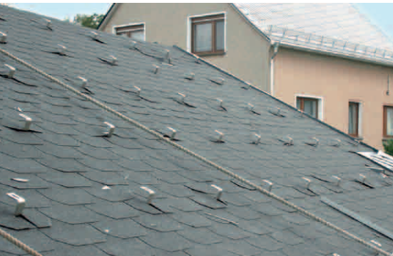
Dach mit Schindeldachhaken
